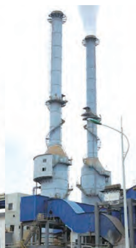
鍋爐超低排放裝置
